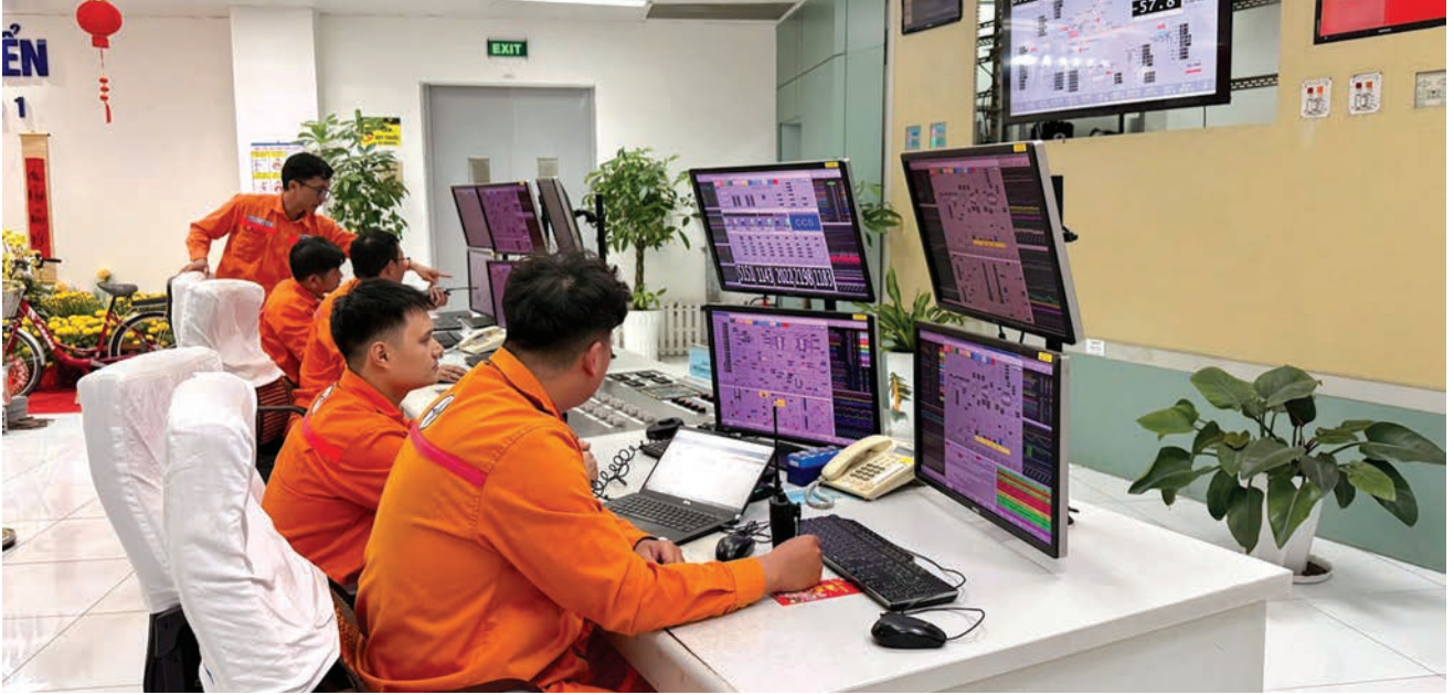
Lực lượng vận hành tại nhà máy điện của EVNGENCO1 bảo đảm vận hành an toàn, ổn định trong giai đoạn chuẩn bị cao điểm mùa khô 2026
