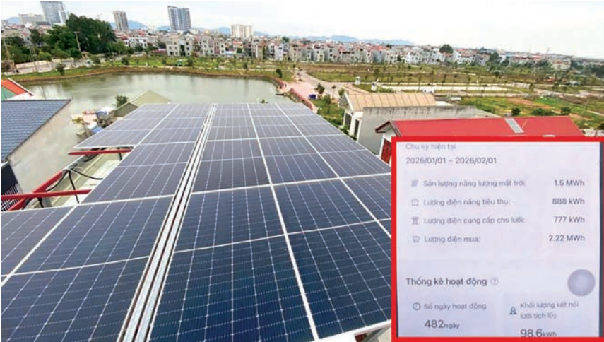
Hệ thống điện mặt trời của gia đình chị Thuỳ tại phường Bắc Giang, tỉnh Bắc Ninh. Nguồn ảnh: ĐVCC
