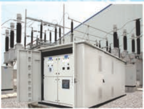
Trạm Kiosk Kiosk substation
