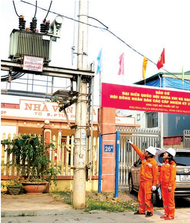
EVNNPC cũng yêu cầu các đơn vị chuẩn bị đầy đủ vật tư, thiết bị, phương tiện và hệ thống thông tin liên lạc; bố trí nguồn điện dự phòng tại các địa điểm trọng yếu nhằm bảo đảm khả năng cấp điện ổn định trong mọi tình huống.
