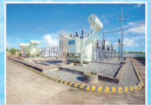
Cung cấp, lắp đặt trọn bộ trạm biến áp Supply and install complete substation
