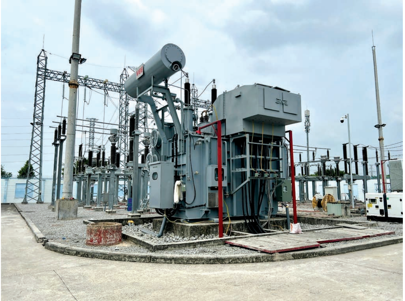
EVNSPC đóng điện, đưa vào vận hành công trình “Trạm 110kV Becamex”, tỉnh Đồng Nai ngày 08/02/2026
