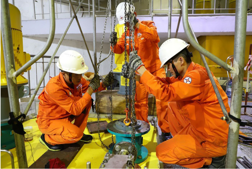
Các công nhân đang bảo dưỡng, sửa chữa thiết bị để các Tổ máy luôn vận hành phát điện an toàn và ổn định
