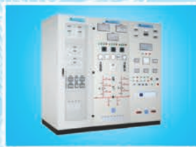
Tủ điện Electric Cubicles
