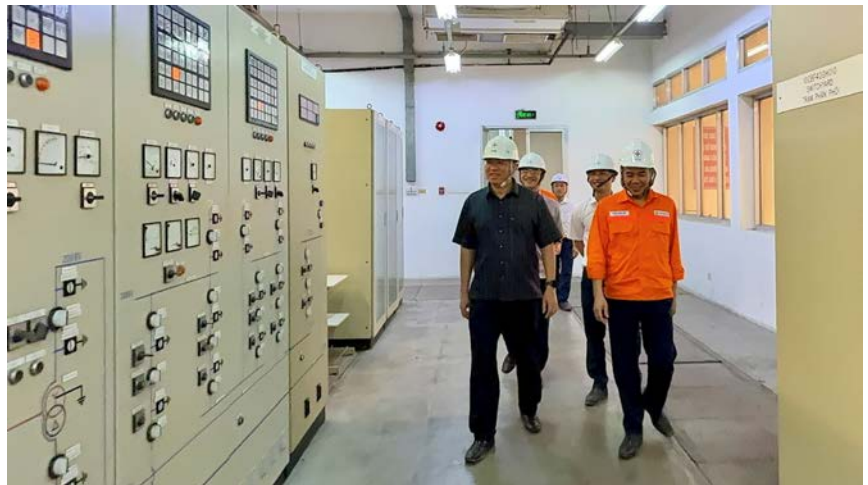
Đoàn công tác kiểm tra thiết bị tại Nhà điều khiển trạm 220kV Công ty Nhiệt điện Uông Bí
