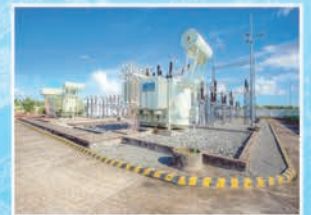
Cung cấp, lắp đặt trọn bộ trạm biến áp Supply and install complete substation
