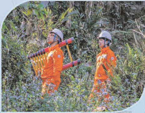
Công nhân điện lực đi kiểm tra lưới điện.
