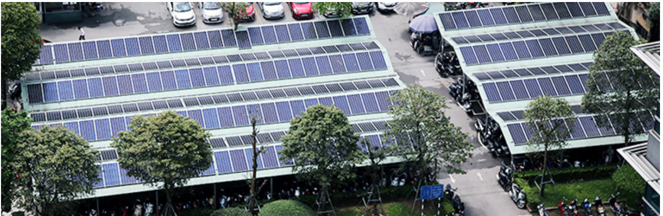
Hệ thống điện mặt trời mái nhà trong khuôn viên trụ sở Tập đoàn Điện lực Việt Nam (phường Ba Đình, Hà Nội). Nguồn ảnh: EVNEIC
