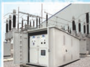
Trạm Kiosk Kiosk substation
