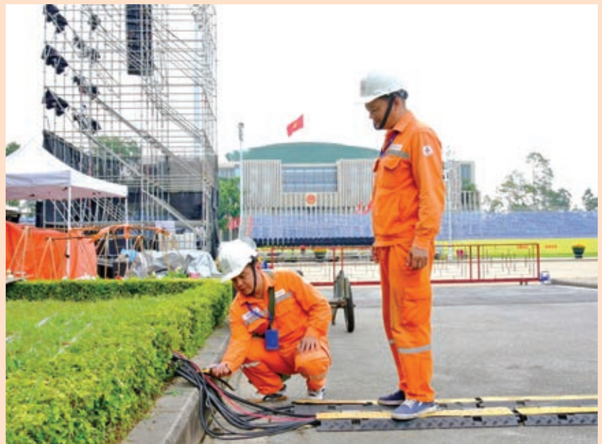
EVNHANOI kiểm tra tình trạng vận hành hệ thống điện tại Quảng trường Ba Đình
