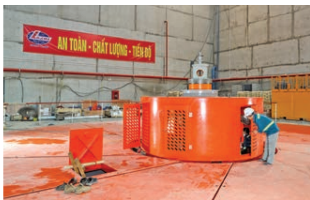
Công tác chuẩn bị cho phát điện tổ máy 1 - Nhà máy Thủy điện Hòa Bình mở rộng đã sẵn sàng
