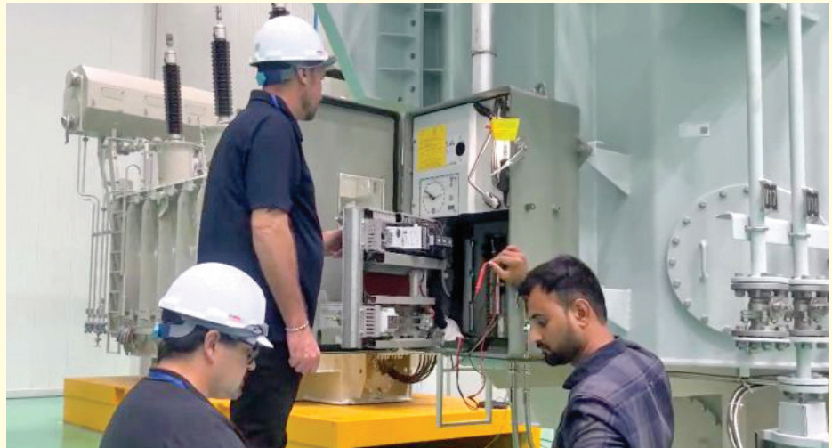
Các chuyên gia của Australia trực tiếp kiểm tra máy biến áp 70 MVA
