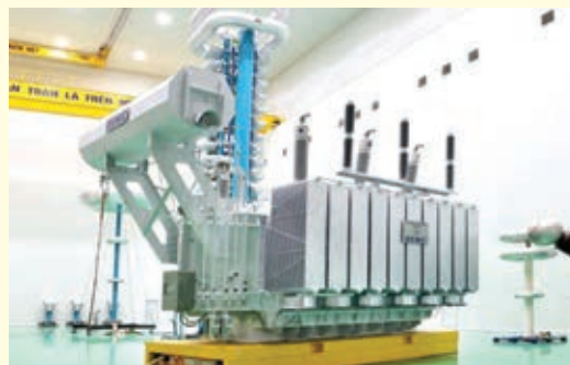
Máy biến áp 70 MVA-132/33 kV trong quá trình thử nghiệm tại Phòng thí nghiệm 500kV của EEMC
