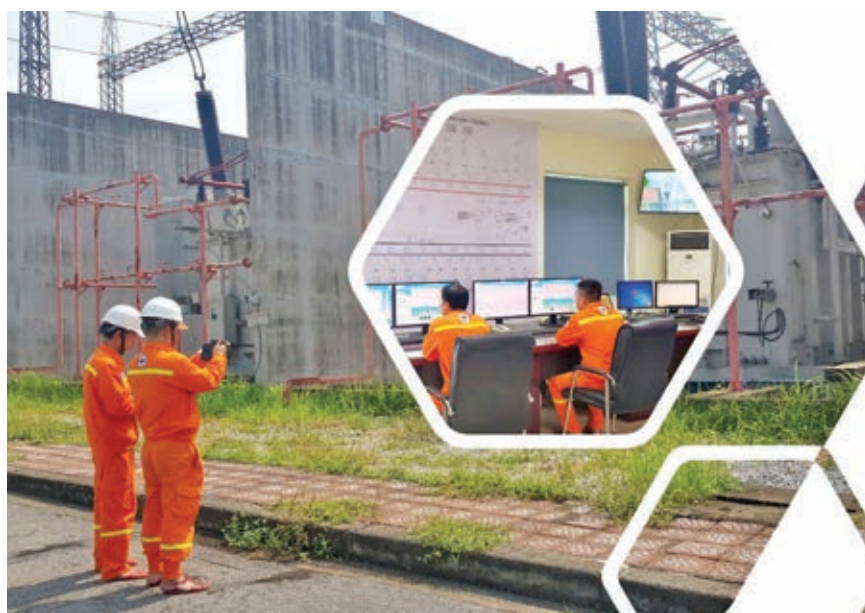
Trực vận hành, kiểm tra soi phát nhiệt tại TBA 500kV Đông Anh
