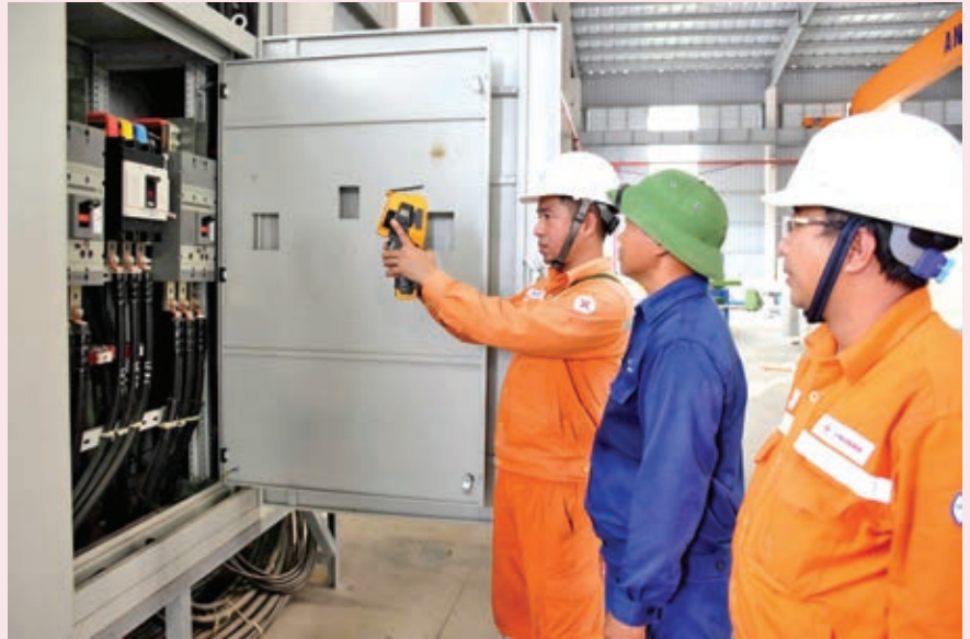
Các cơ sở sản xuất, kinh doanh cần thường xuyên kiểm tra hệ thống điện để kịp thời phát hiện và xử lý các hư hỏng
