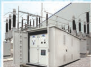
Trạm Kios Kiosk substation
