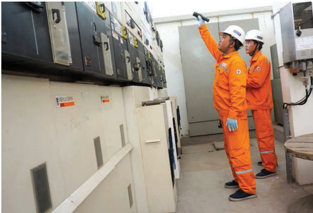
EVNHCMC đảm bảo vận hành an toàn hệ thống điện phục vụ tốt kỳ thi tuyển sinh lớp 10 năm 2025.
