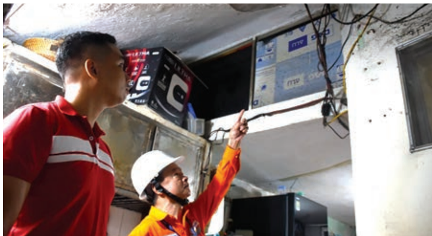
Người dân tự ý đấu nối các đường dây điện không đảm bảo an toàn sẽ tiềm ẩn nguy cơ tai nạn về điện cũng như cháy, nổ
