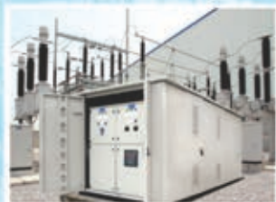
Trạm Kios Kiosk substation
