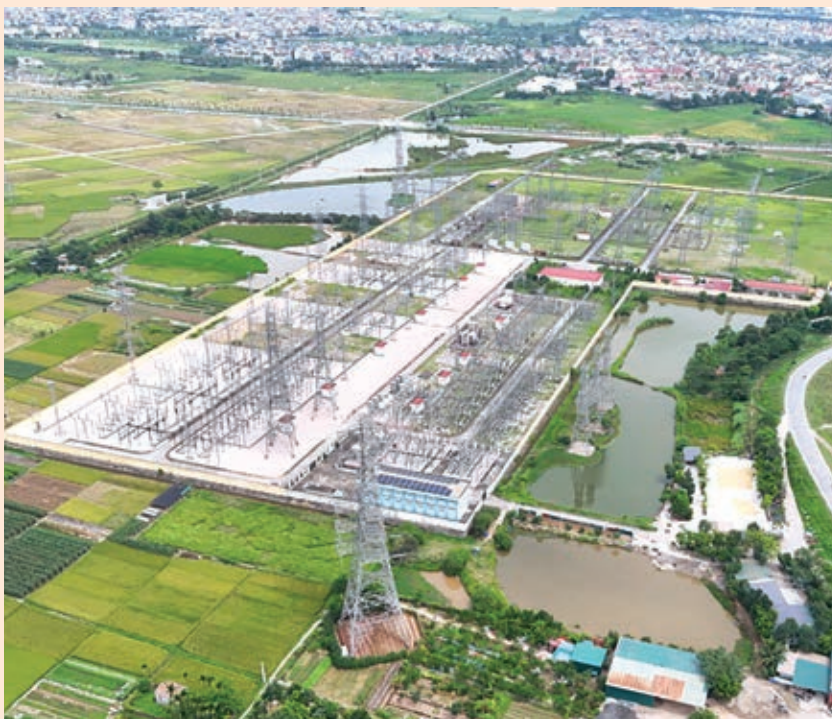
Trạm 500kV Tây Hà Nội nhìn từ trên cao
