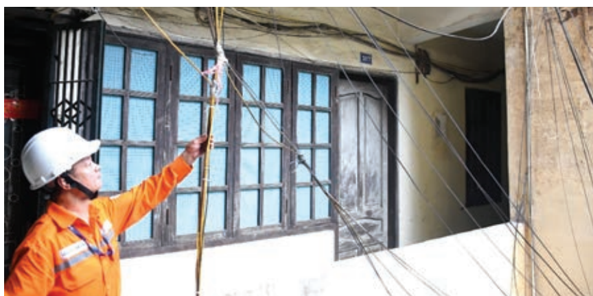
Những cụm dây điện do người dân tự đấu nối
