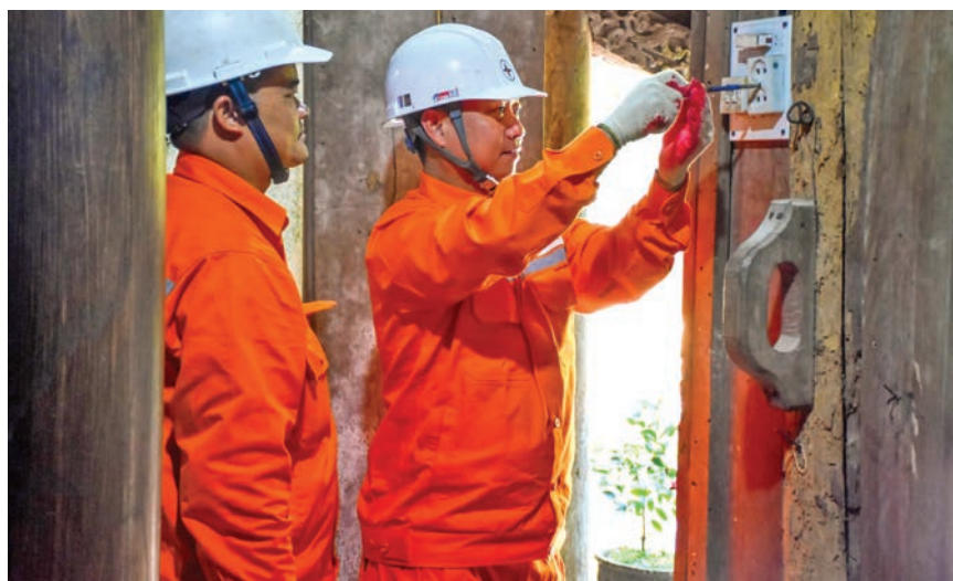
Cán bộ công nhân viên EVNHANOI thực hiện kiểm tra thiết bị điện
