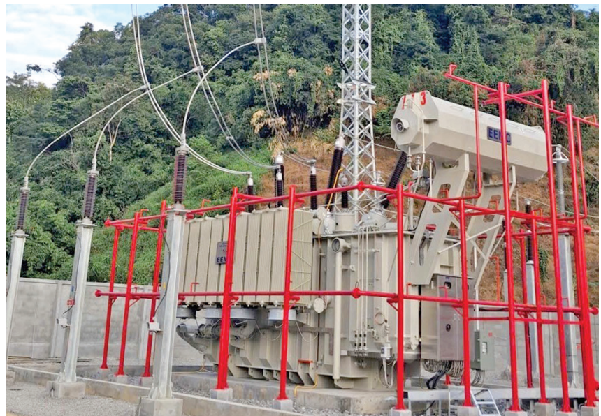
Máy biến áp AT3 220 kV-250 MVA TBA 220 kV Mường Tè (Lai Châu)
