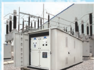
Trạm Kios Kiosk substation
