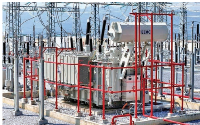
Máy biến áp 220 kV-250 MVA Trạm biến áp 220 kV Phú Thọ 2
