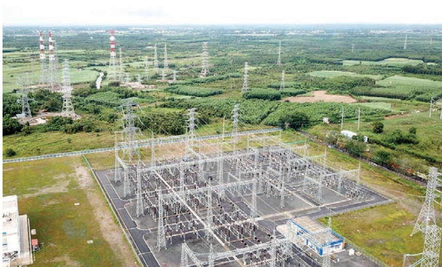
Đường dây 220kV Nhà máy điện Nhơn Trạch 3 - rẽ Mỹ Xuân - Cát Lái từ sân phân phối Nhà máy điện Nhơn Trạch 3. Ảnh: Lê Linh
