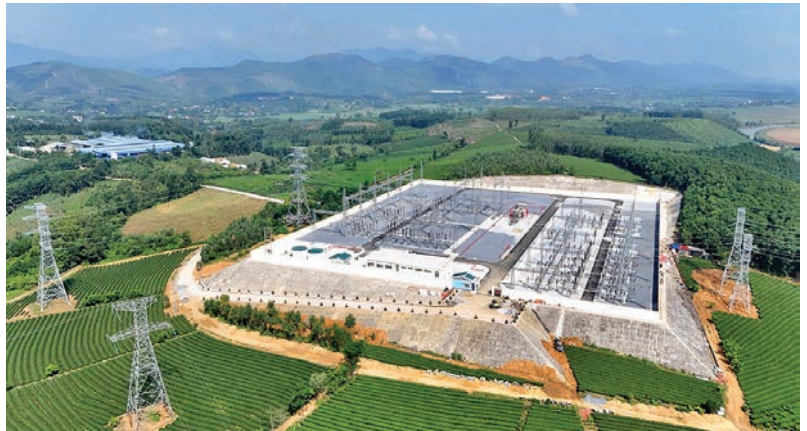
Trạm biến áp 220kV Phú Thọ và đường dây đấu nối
