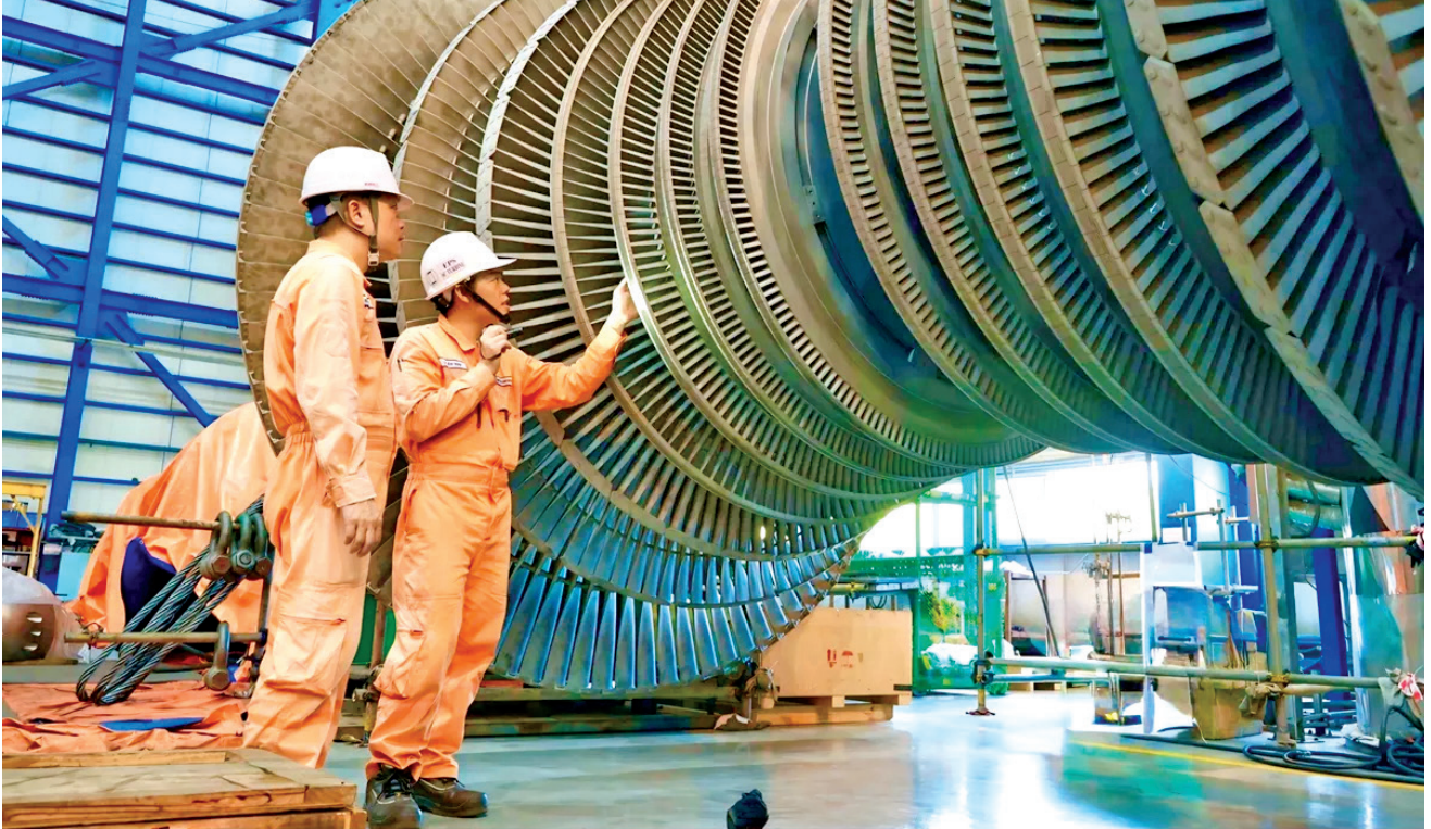
CBCNV EVNGENCO3 chủ động nâng cao năng lực quản lý, vận hành, sửa chữa bảo dưỡng các nhà máy điện
