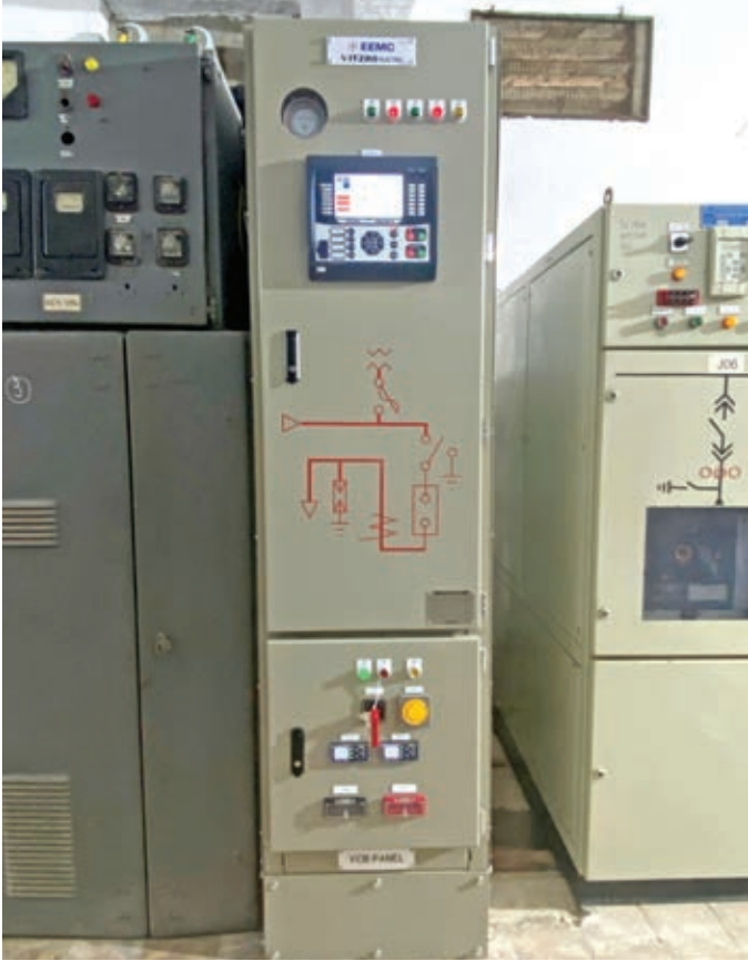
Thiết bị GIS khí khô đang vận hành tại trạm điện chính của EEMC
