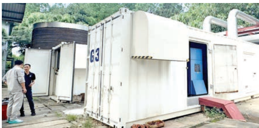
Khu vực máy phát điện dự phòng tại Trung tâm Hội nghị Quốc gia được kiểm tra và chuẩn bị kỹ lưỡng, đảm bảo phục vụ Đại hội Đảng bộ Chính phủ và các sự kiện quan trọng sắp tới
