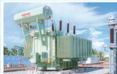
Máy biến áp truyền tải 110 - 220 kV
