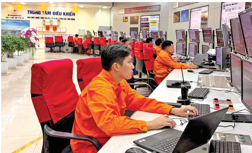
Các đơn vị của EVNGENCO1 duy trì vận hành an toàn, ổn định các tổ máy, góp phần bảo đảm cung ứng điện cho hệ thống điện quốc gia
