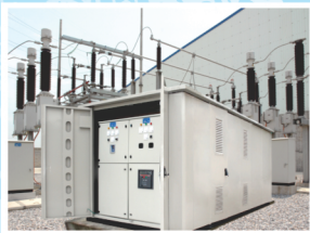
Trạm Kios Kiosk substation
