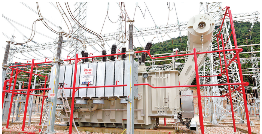
Máy biến áp AT1 220 kV - 250 MVA vận hành tại trạm 220 kV Phú Quốc
