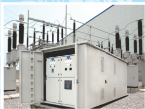
Trạm Kios Kiosk substation
