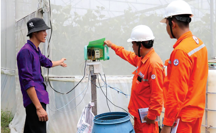
Không lắp đặt các thiết bị điện quá thấp, gần nơi ẩm ướt (ảnh: Thành Đạt)
