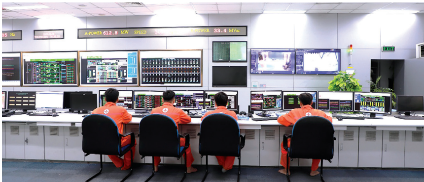
Các vận hành viên làm việc tại Phòng Điều khiển trung tâm Nhà máy Nhiệt điện Vĩnh Tân 2
