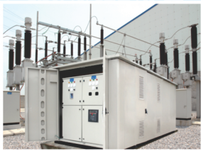
Trạm Kios Kiosk substation
