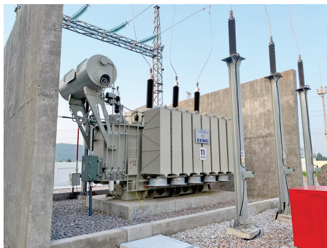
Máy biến áp 63 MVA do EEMC cung cấp đang vận hành tại trạm 110 kV KCN Yên Lữ
