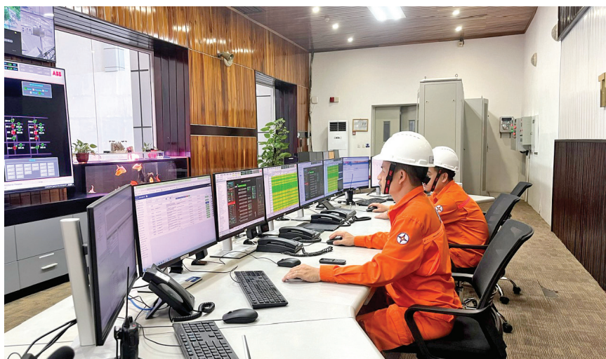
EVNGENCO1 duy trì vận hành an toàn, ổn định các nhà máy điện, góp phần bảo đảm cung ứng điện trong giai đoạn cao điểm mùa khô năm 2026
