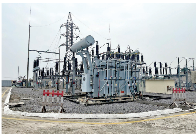
Hình ảnh máy biến áp T1 25 MVA - 115/38,5/23 kV trước khi thay thế
