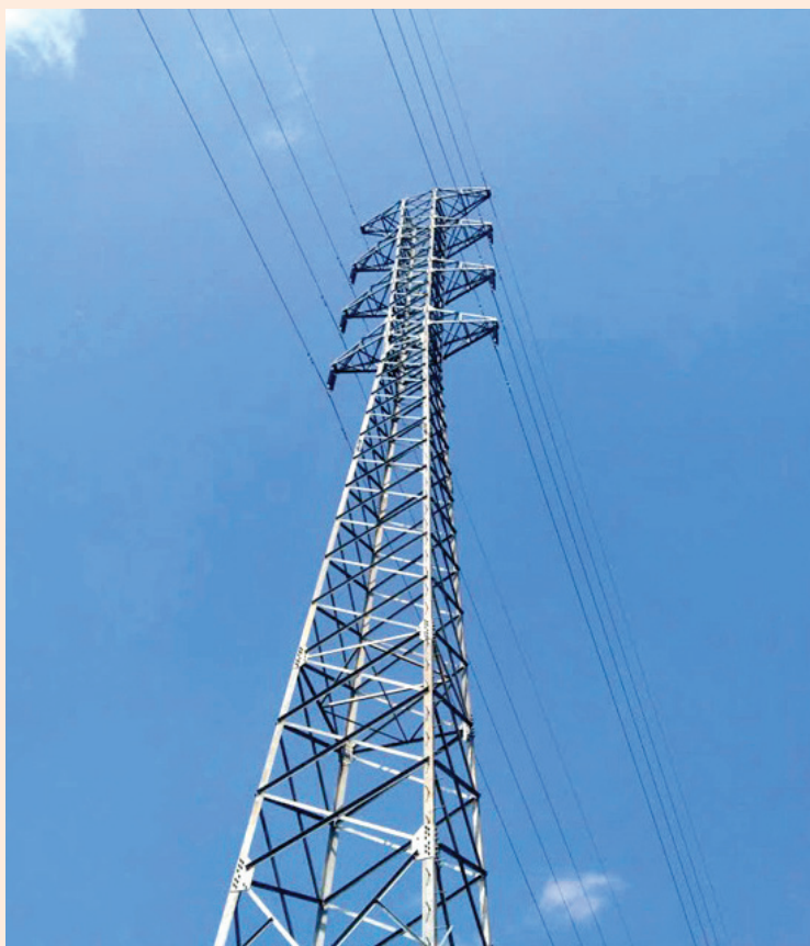
Đường dây 110kV Phú Thuận - Bình Đại đã được đóng điện từ 22/4/2026
