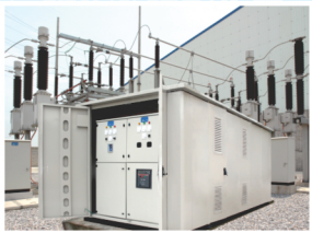
Trạm Kios Kiosk substation
