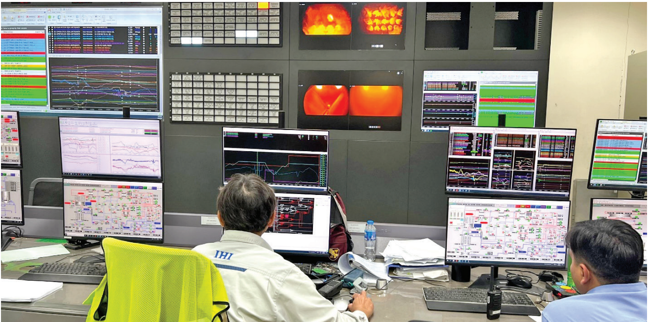
Trực vận hành Nhà máy Nhiệt điện Quảng Trạch 1
