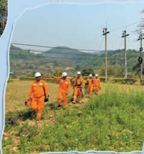
Công nhân PC CAO BẰNG khắc phục nhanh sự cố đường điện Bán Khau xã Thống Nhất (Hà Lang - Cao Bằng).
