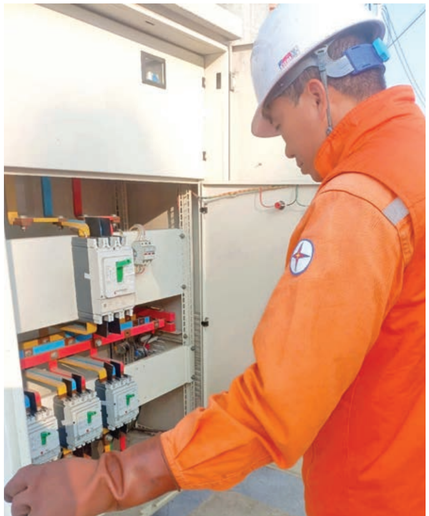
Đội QLVH - Điện lực Chí Linh kiểm tra các TBA cấp điện cho các sự kiện Lễ hội
