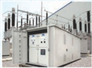
Trạm Kios Kiosk substation
