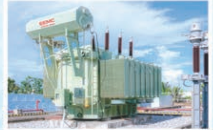
Máy biến áp truyền tải 110 - 220kV 110 - 220kV transformer
