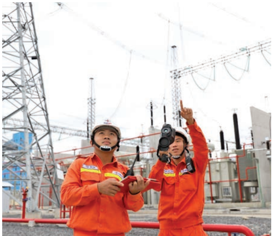
Nhân viên vận hành Trạm biến áp của EVNNPT tăng cường kiểm tra tình trạng vận hành
