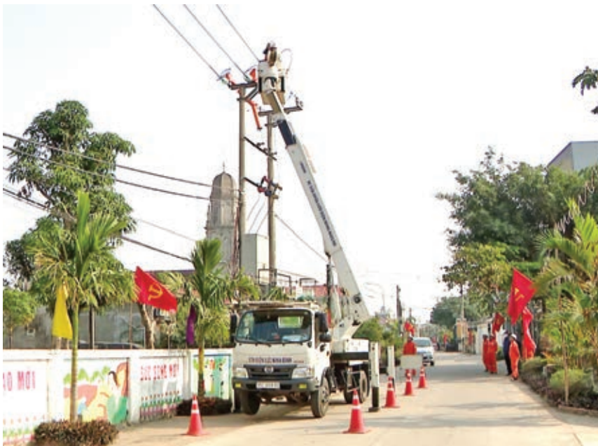
Thi công các công trình điện được đầu tư trên địa bàn huyện Yên Khánh
