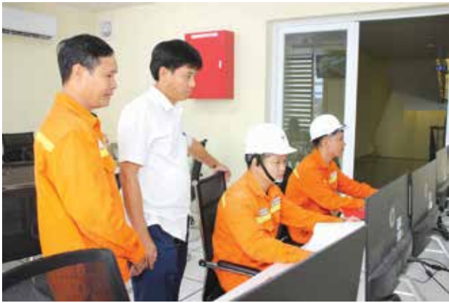
Ông Nguyễn Duy Dũng – Phó Giám đốc PTC2 kiểm tra tình hình vận hành tại Trạm GIS 220kV Hải Châu.
