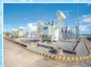
Cung cấp, lắp đặt trọn bộ trạm biến áp Supply and install complete substation
