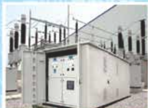
Trạm Kiosk Kiosk substation
