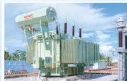
Máy biến áp truyền tải 110 - 220kV 110 - 220kV transformer
