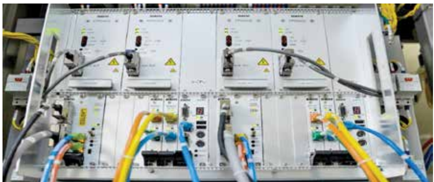
Hình ảnh các hệ thống thiết bị điều khiển trong mô hình
