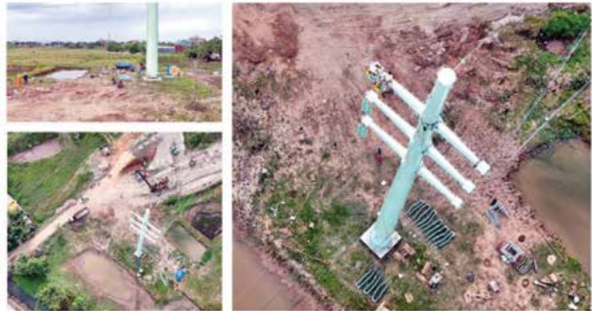
Vị trí cột 144A (km55+980 đường vành đai 4, thuộc xã Ninh Sở, huyện Thường Tín)
