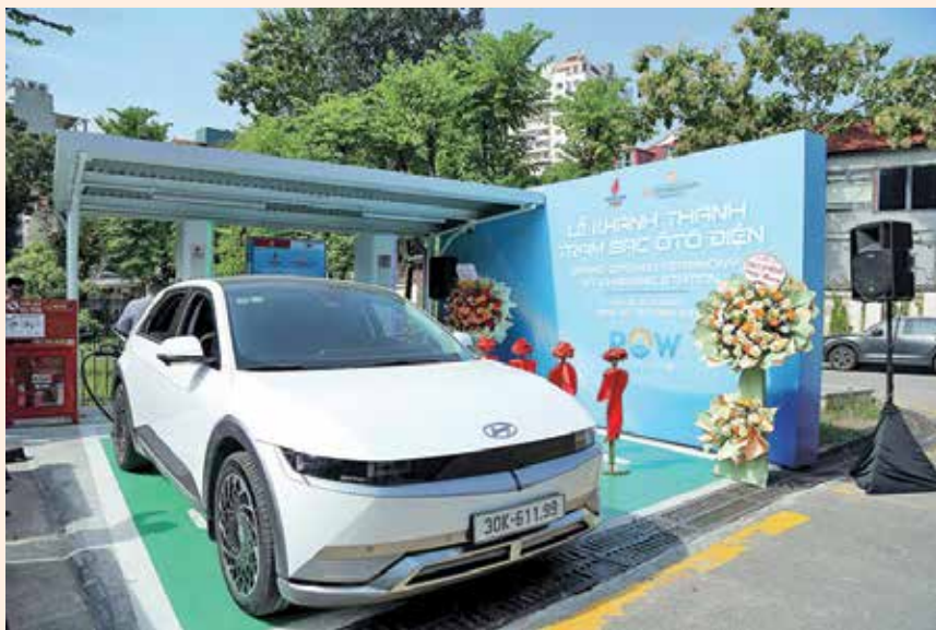
Trạm sạc xe điện thí điểm đầu tiên của PV Power tại số 6 Huỳnh Thúc Kháng, Hà Nội
