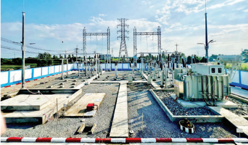
Công trình “Trạm 110kV khu công nghiệp (KCN) Trường Xuân và đường dây đấu nối, tỉnh Đồng Tháp” đã đóng điện thành công lúc 17h46 ngày 15/11/2024
