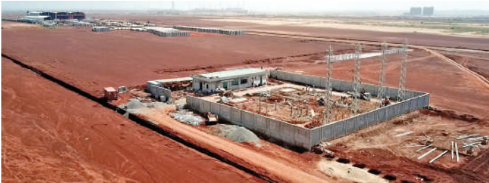
Trạm biến áp 110kV Sân bay Long Thành dự kiến sẽ hoàn thành giao đoạn 1 vào cuối tháng 11/2024
