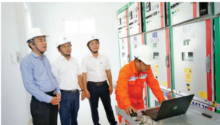
Lãnh đạo EVNSPC trực tiếp kiểm tra công tác đóng điện tại Trạm biến áp 110kV Khánh Bình – Bình Dương
