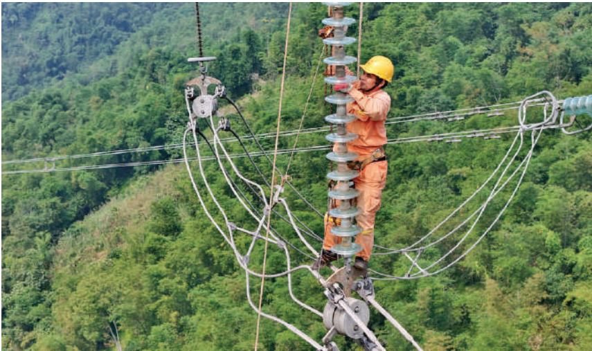
Thay sứ tại vị trí 354, ĐZ 500kV Sơn La - Hòa Bình
