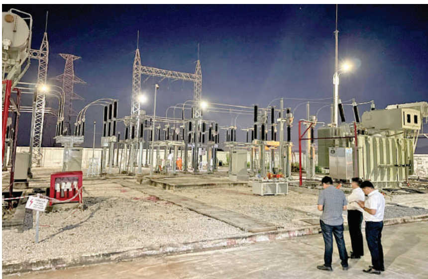
Ngày 14/11/2024, EVNSPC đóng điện thành công Dự án “Lắp máy 2 Trạm biến áp 110kV Long Điền (An Ngãi)
