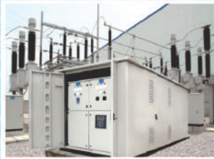
Trạm Kios Kiosk substation
