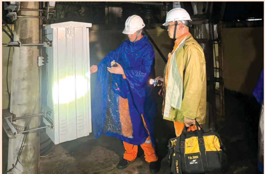
Công nhân EVNHANOI kiểm tra trạm điện Lương Phúc 1 tại xóm Hồ Sen, thôn Lương Phúc
