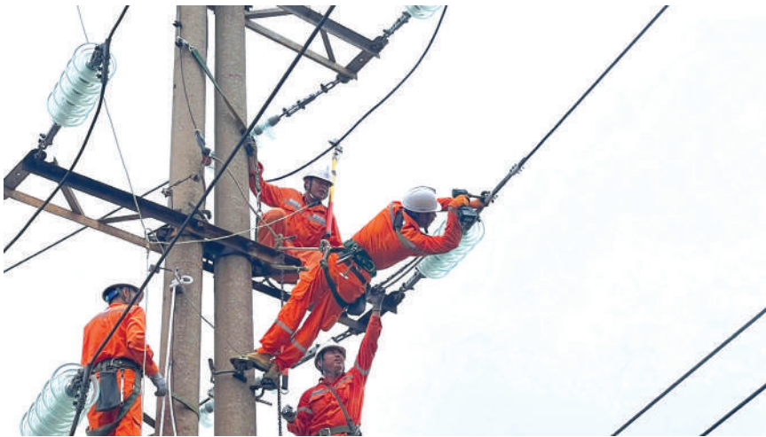
Đội xung kích Công ty Điện lực Hà Tĩnh đã, đang nỗ lực ngày đêm khắc phục lưới điện Hải Phòng nhằm sớm cấp điện trở lại phục vụ bà con
