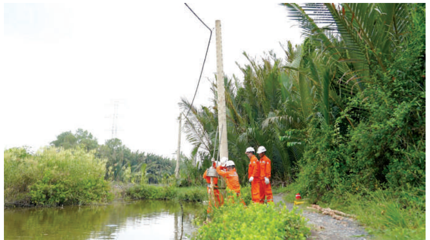
Đội quản lý Lưới điện Công ty Duyên Hải đang gia cố kết cấu móng trụ điện có nguy cơ sạt lở
