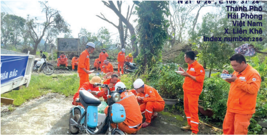
Đội xung kích tại Hải Phòng tranh thủ ăn cơm ngay tại hiện trường để tiếp tục làm thông trưa, kịp thời đóng điện phục vụ nhân dân
