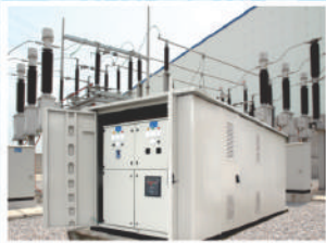
Trạm Kiosk Kiosk substation
