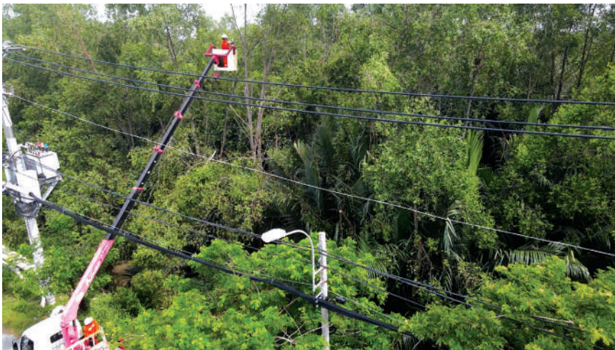
Đội quản lý Lưới điện Công ty Duyên Hải cắt tỉa, mé nhánh cây hành lang lưới điện 22kV trên đường Nguyễn Bình
