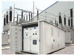
Trạm Kios Kiosk substation
