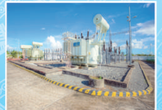
Cung cấp, lắp đặt trọn bộ trạm biến áp Supply and install complete substation
