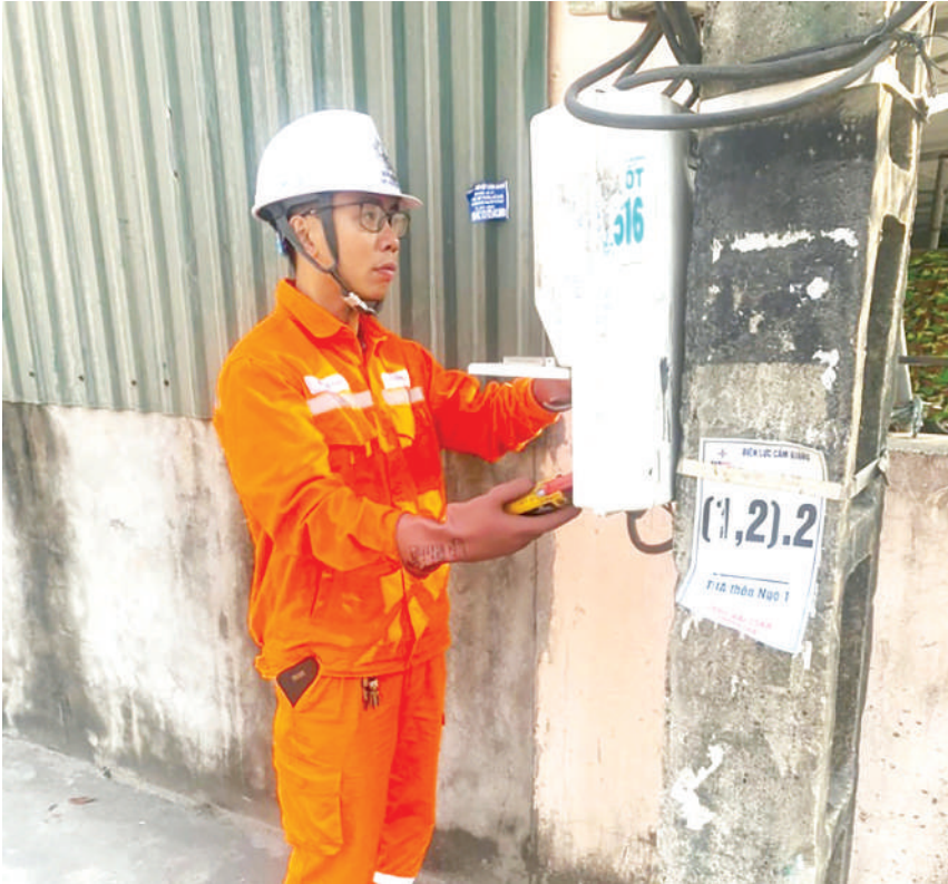
Công nhân ĐL Cẩm Giàng kiểm tra, rà soát công tơ điện tử đo xa thuộc TBA Thôn Ngõ - Điện lực Cẩm Giàng
