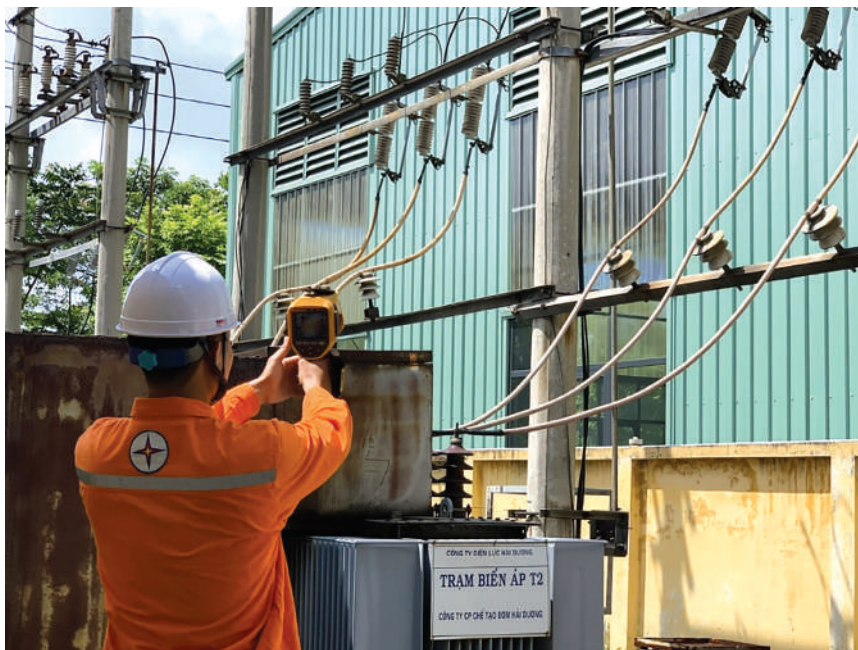
Nhân viên Điện lực TP Hải Dương kiểm tra kỹ thuật đảm bảo điều kiện vận hành thiết bị điện tại Nhà máy chế tạo Bơm Hải Dương
