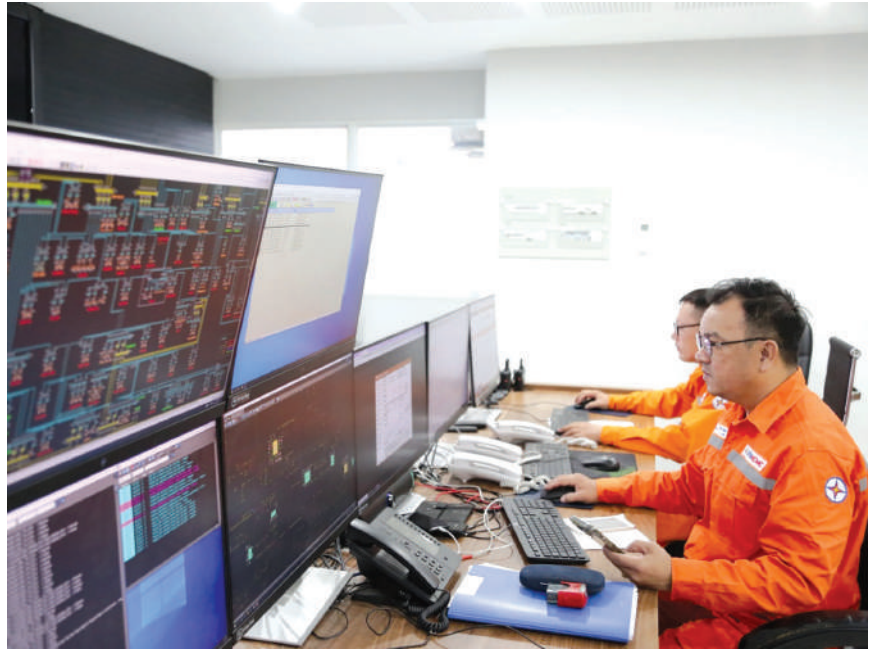
Các kíp trực luôn theo dõi tình hình vận hành lưới điện, đảm bảo cung cấp điện ổn định, liên tục cho nhu cầu tiêu thụ điện của TP. HCM
