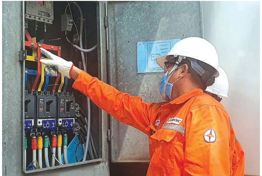
Công nhân ngành điện TP. Hồ Chí Minh kiểm tra hệ thống điện nhằm đảm bảo cung cấp điện an toàn, ổn định, tin cậy phục vụ nhân dân trong các ngày Lễ Quốc khánh 2/9
