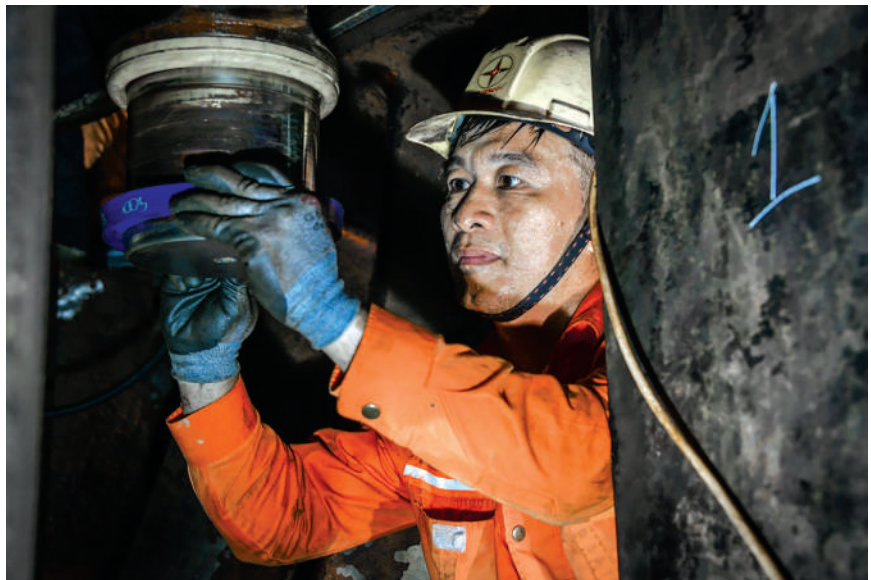
Công tác bảo dưỡng sửa chữa được điều phối linh hoạt và hiệu quả để đảm bảo sản xuất
