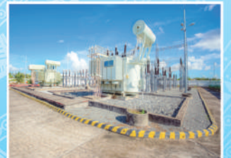
Cung cấp, lắp đặt trọn bộ trạm biến áp Supply and install complete substation
