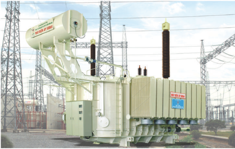
EEMC - NHÀ SẢN XUẤT DUY NHẤT TẠI ĐÔNG NAM Á THIẾT KẾ, CHẾ TẠO THÀNH CÔNG MÁY BIẾN ÁP 500KV EEMC - THE ONLY MANUFACTURER IN SOUTHEAST ASIA SUCCESSFULLY DESIGNED, PRODUCED 500KV TRANSFORMER
