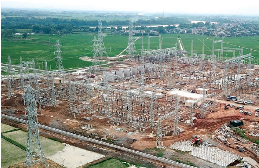
Trạm biến áp 500kV Thanh Hóa trước khi đóng điện
