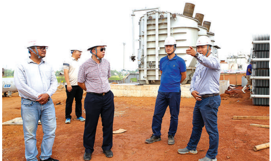
Lãnh đạo EVNNPT kiểm tra tiến độ thi công xây dựng và lắp đặt thiết bị tại TBA 500kV Thanh Hóa, tháng 5/2024
