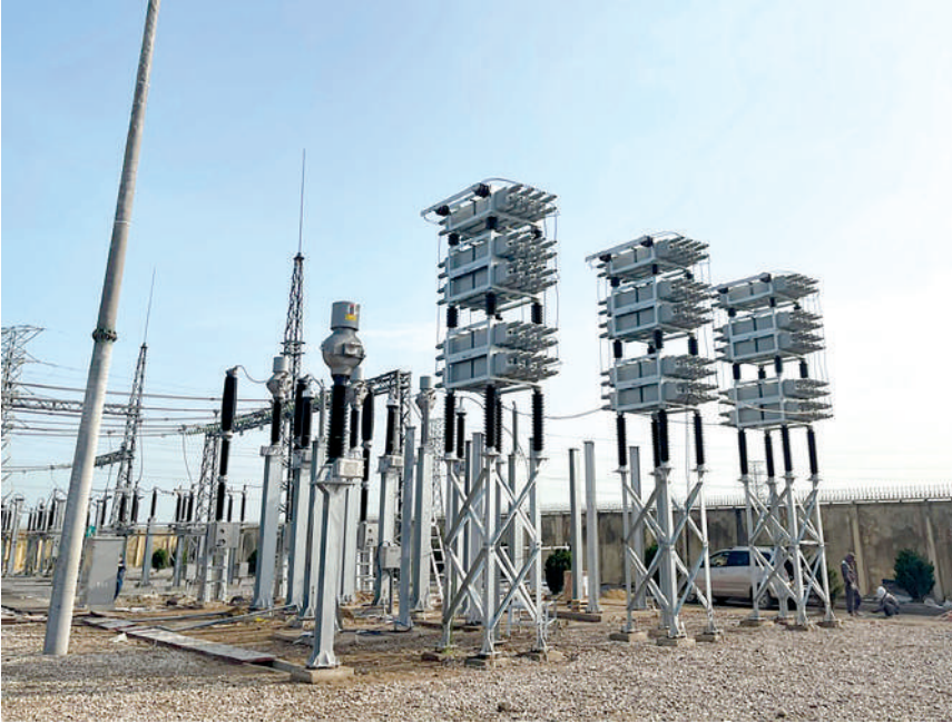
EVNNPT hoàn thành lắp đặt tủ bù ngang của 8 trạm biến áp 220kV, sẵn sàng đảm bảo điện cho khu vực phía Bắc từ mùa nắng nóng 2024. Trong ảnh: Giàn tủ bù ngang 110kV -50MVAR tại Trạm biến áp 220kV Thanh Nghị (Hà Nam)
