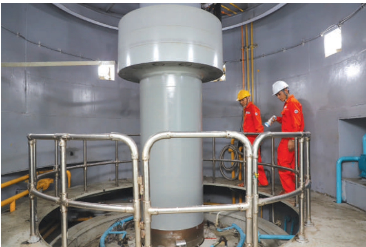
Nhân viên vận hành Công ty Thủy điện Sông Bung kiểm tra hệ thống tuabin thủy lực
