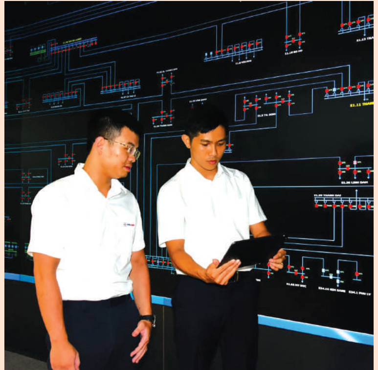
Các điều độ viên kiểm tra thông số vận hành hệ thống điện
