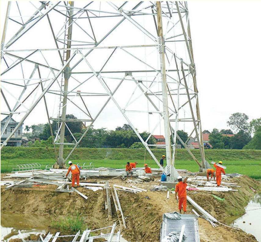
Giám sát lắp dựng cột tại vị trí 177 Đường dây 500kV Quỳnh Lưu - Thanh Hóa
