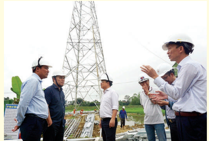
Đoàn công tác kiểm tra và nghe đại diện TTĐ Thanh Hóa báo cáo công tác giám sát lắp dựng cột tại vị trí 177 Đường dây 500kV Quỳnh Lưu -Thanh Hóa
