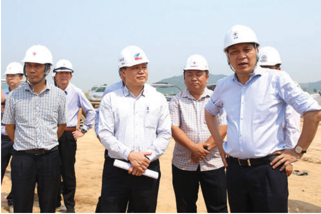
Lãnh đạo EVN và EVNNPT kiểm tra và nghe báo cáo tiến độ thi công vị trí móng do nhà thầu Thăng Long TIC thi công
