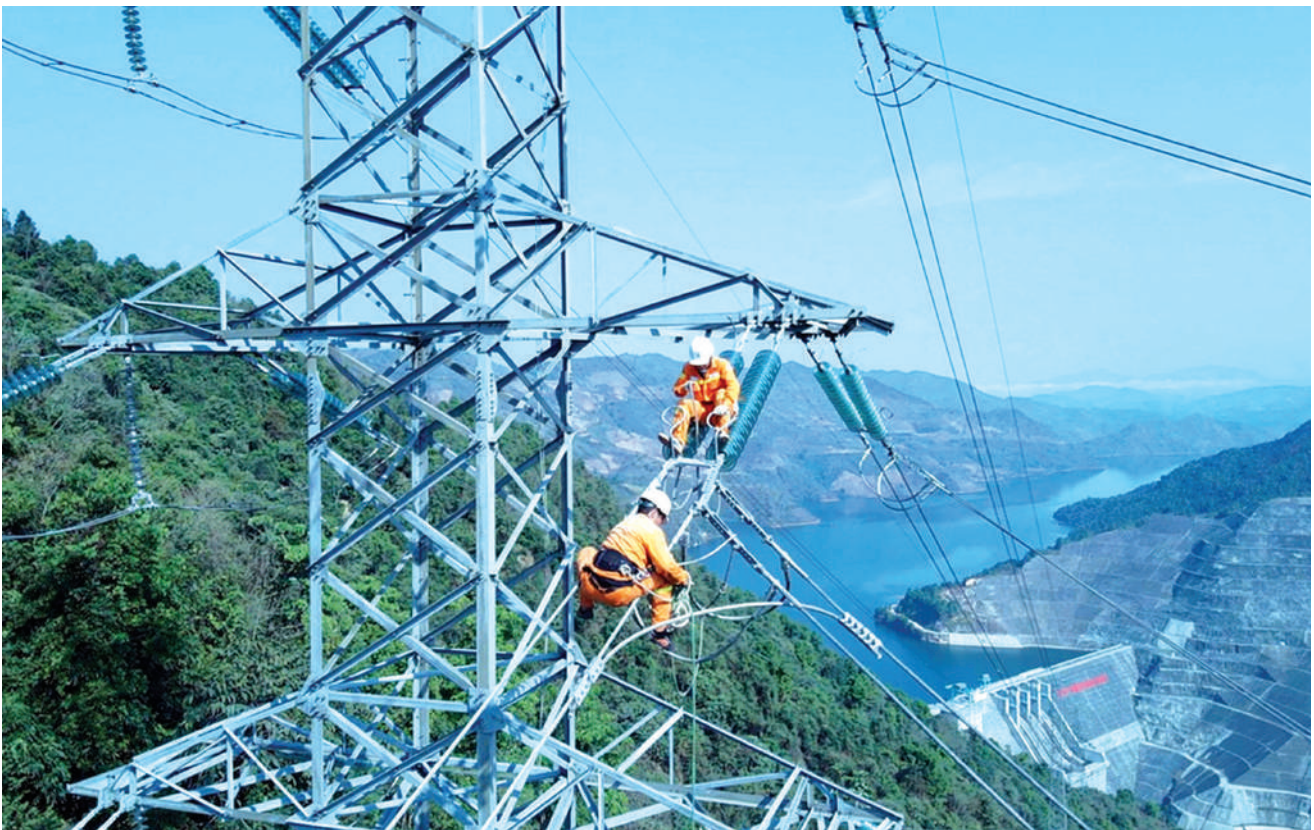
Lắp bổ sung lều phụ chống quá tải phát nhiệt cho đường dây 220kV NMTĐ Huệi Quảng -TBA 220kV Than Uyên
