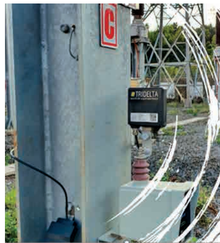
Hình 5. Lắp đặt bộ giám sát CSV TRIDELTA
