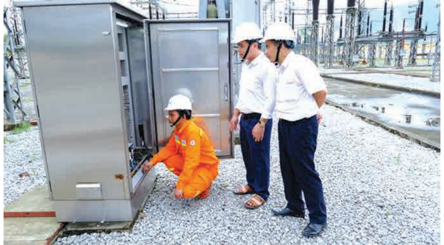
Lãnh đạo Truyền tải điện Thanh Hóa trực tiếp xuống các TBA trên địa bàn quản lý để kiểm tra công tác quản lý, vận hành
