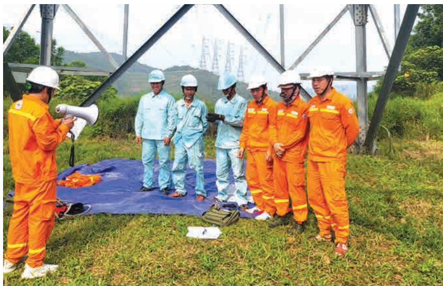
Phổ biến phương án, qui trình, công tác an toàn trước khi thực hiện vệ sinh cách điện
