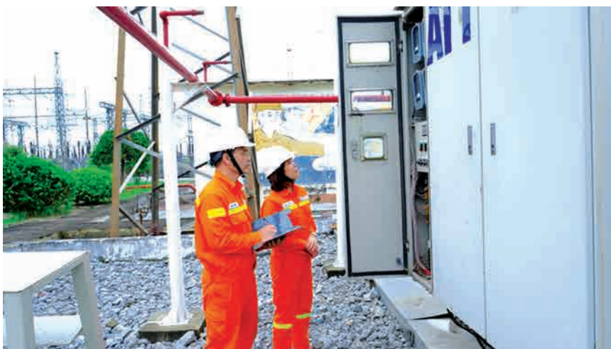
Cán bộ công nhân viên thuộc TBA 220kV Ba Chè – Truyền tải điện Thanh Hóa thực hiện công tác kiểm tra, ứng trực thường xuyên đảm bảo không có sự cố xảy ra
