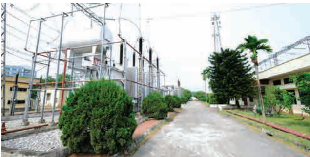
Máy biến áp AT2 - TBA 220kV Mai Động đang được vận hành an toàn
