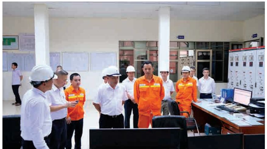
Lực lượng vận hành tại TBA 500kV Nho Quan báo cáo tình hình vận hành, tải điện cao điểm nắng nóng
