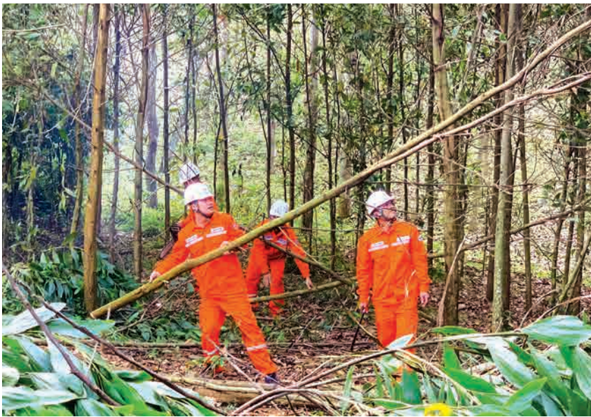
Công nhân Công ty Điện lực Thanh Hóa chặt tỉa cây giải phóng hành lang, đảm bảo an toàn lưới điện.
