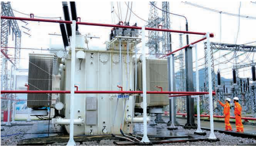
Để đảm bảo nhiệt độ cho máy biến áp hoạt động trong điều kiện nhiệt độ ngoài trời ở mức cao, TBA 220KV Nghi Sơn đã thực hiện hệ thống làm mát cưỡng bức bằng cách phun nước xung quanh
