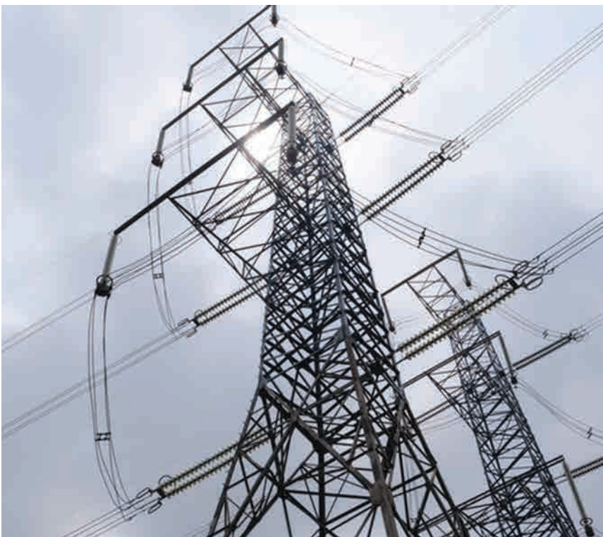
Nhiều tuyến đường dây 220kV-500kV do TTĐ Đông Bắc 1 quản lý, đang vận hành trong điều kiện nắng nóng và ở mức tải cao
