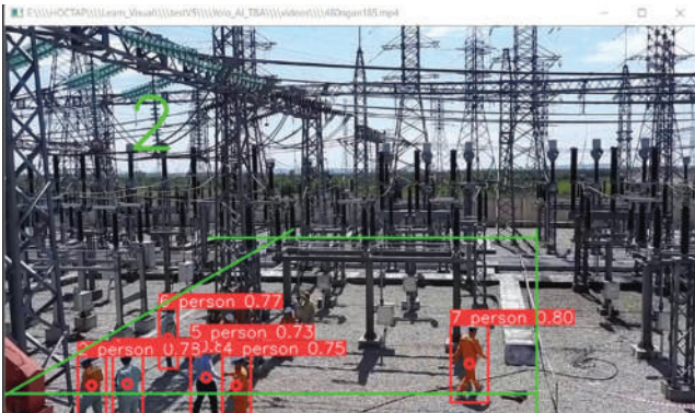
Hệ thống cảnh báo vi phạm khoảng cách an toàn, yêu cầu quay lại nơi làm việc an toàn
