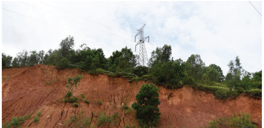
Vị trí số 17 thuộc ĐD 220kV Phả Lại - Bắc Giang đang bị sạt lở hiện Truyền tải điện Đông Bắc 1 đã khắc phục tạm thời
