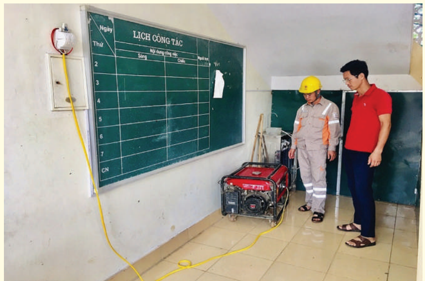
Công nhân Điện lực kiểm tra máy phát điện dự phòng tại điểm thi
